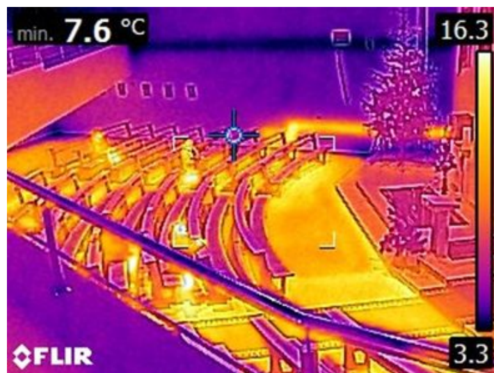
Obr. č.6: Hlavné úniky tepla zapríčiňujú tenké a nezaizolované konštrukcie, preklady a slabý obvodový múr. Žltou farbou je vidieť vykurovací systém.
