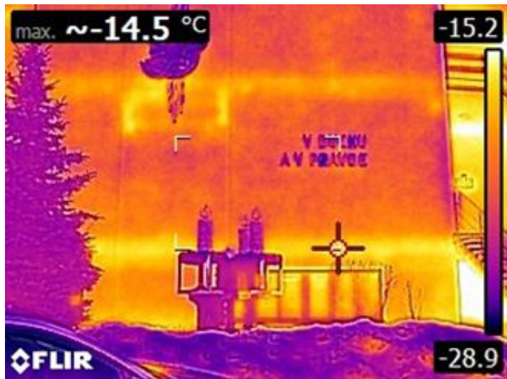
Obr. č.1: Z vonkajšej strany sú viditeľné všetky betónové preklady, ktoré výrazne odovzdávajú teplo do vonkajšieho prostredia a tým ochladzujú vnútorné priestory.
